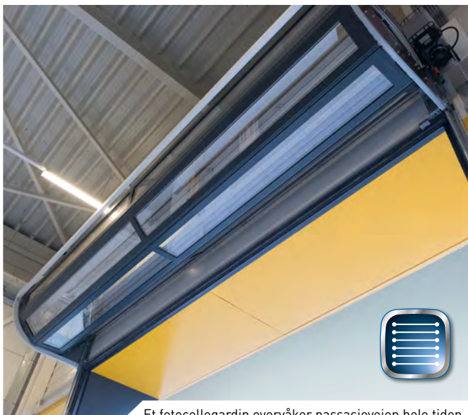
Et fotocellegardin overvåker passasjeveien hele tiden
